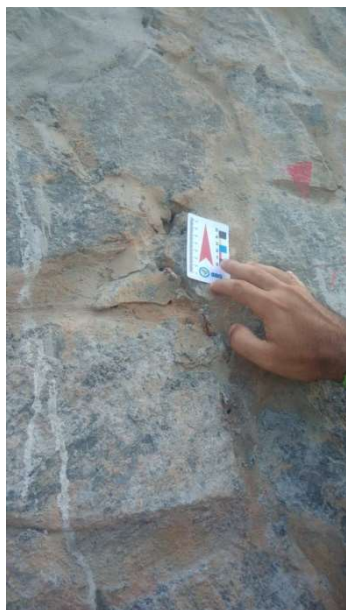
Figura 12: Fissuração na estrutura
