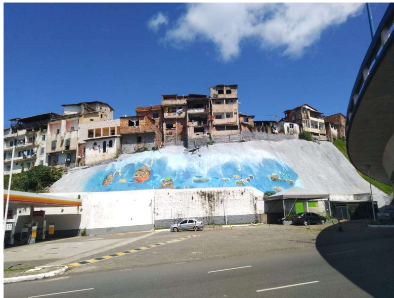
Figura 18: Obra de contenção realizada por meio de concretagem em cima de lona plástica.
