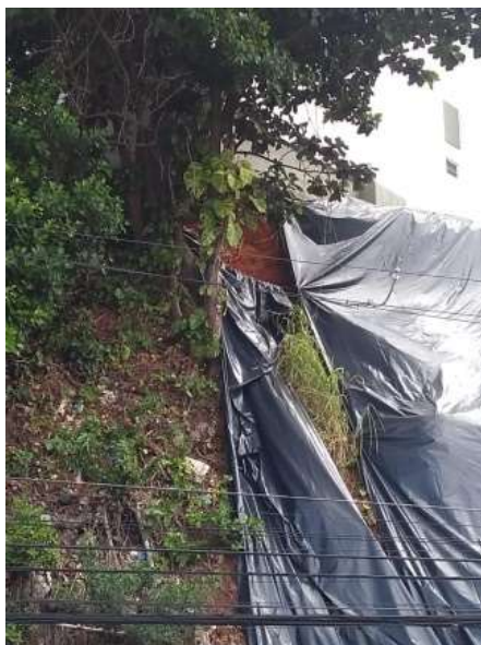
Figura 17: Lona já em processo de deterioramento
