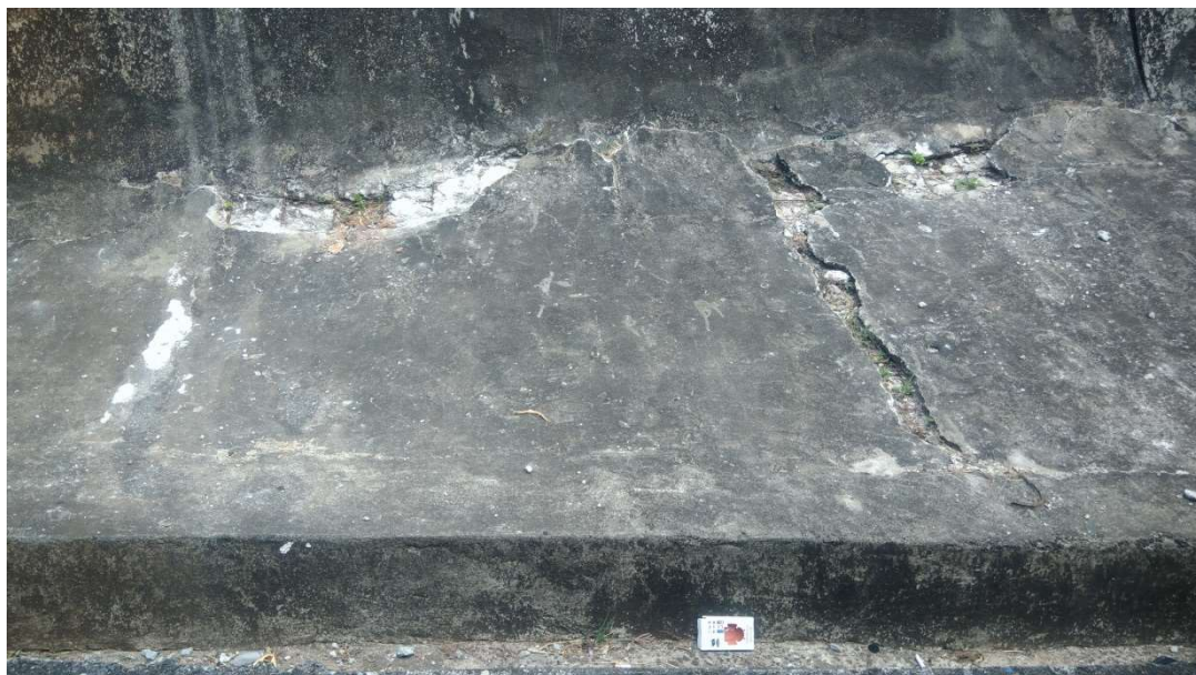
Figura 6: Rachaduras na estrutura da contenção com ferragens expostas e oxidadas
