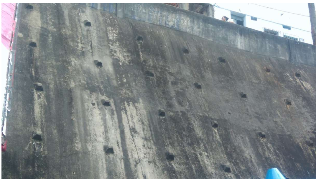
Figura 4: Contenção de solos grampeados
